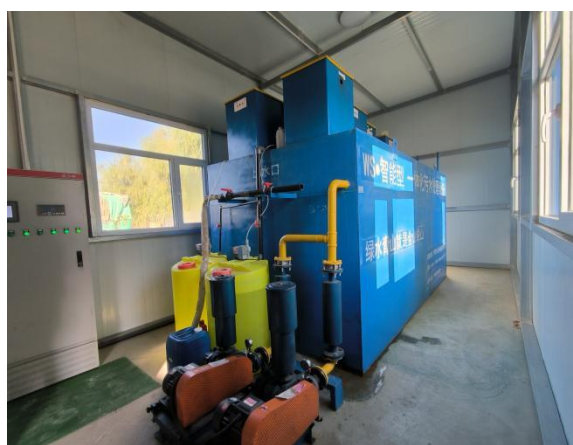
污水处理设备
