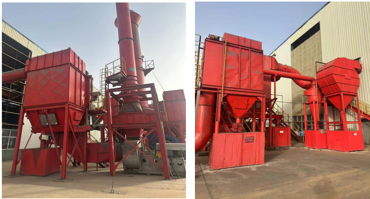
除尘器及排气筒
